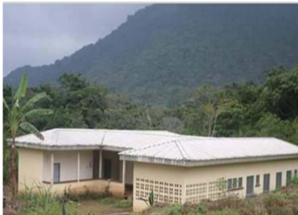
Photo n°1: Centre Médicale d'Arrondissement de Ninong, non fonctionnel, abandonné dans la broussaille
