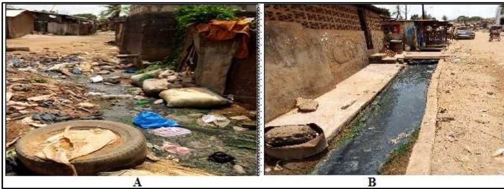
Planche n°1 : Eaux usées stagnantes dans un quartier précaire de Bingerville
